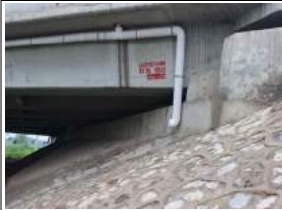
桥梁雨水收集系统
