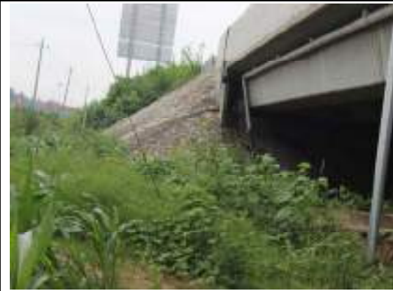
桥梁雨水收集系统
