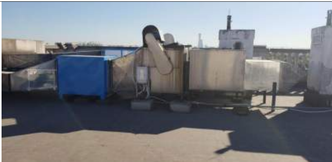
图3-3 油烟净化器及排放口照片
