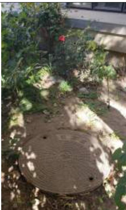
图3-2 生活污水排放口照片
