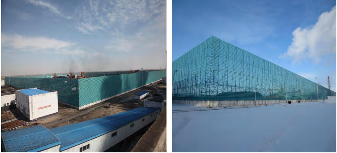
图 3.2.4-3 煤场防风抑尘网除尘器
