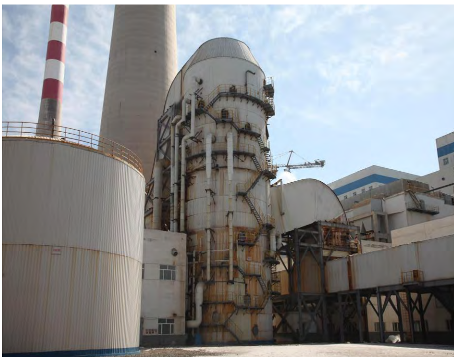
图 3.2.4-2 锅炉脱硫设施
