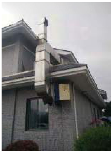
食堂油烟净化器及排放管
