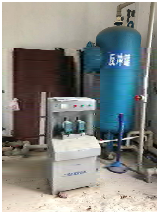
过滤及备用消毒装置
