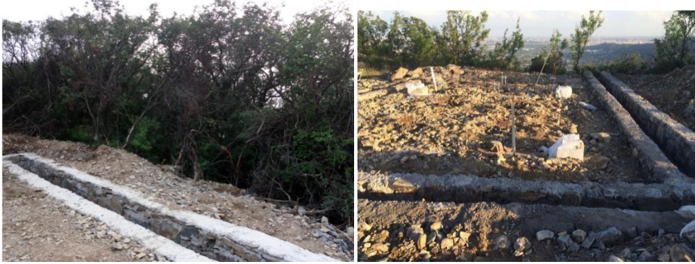
排水沟、截洪沟
