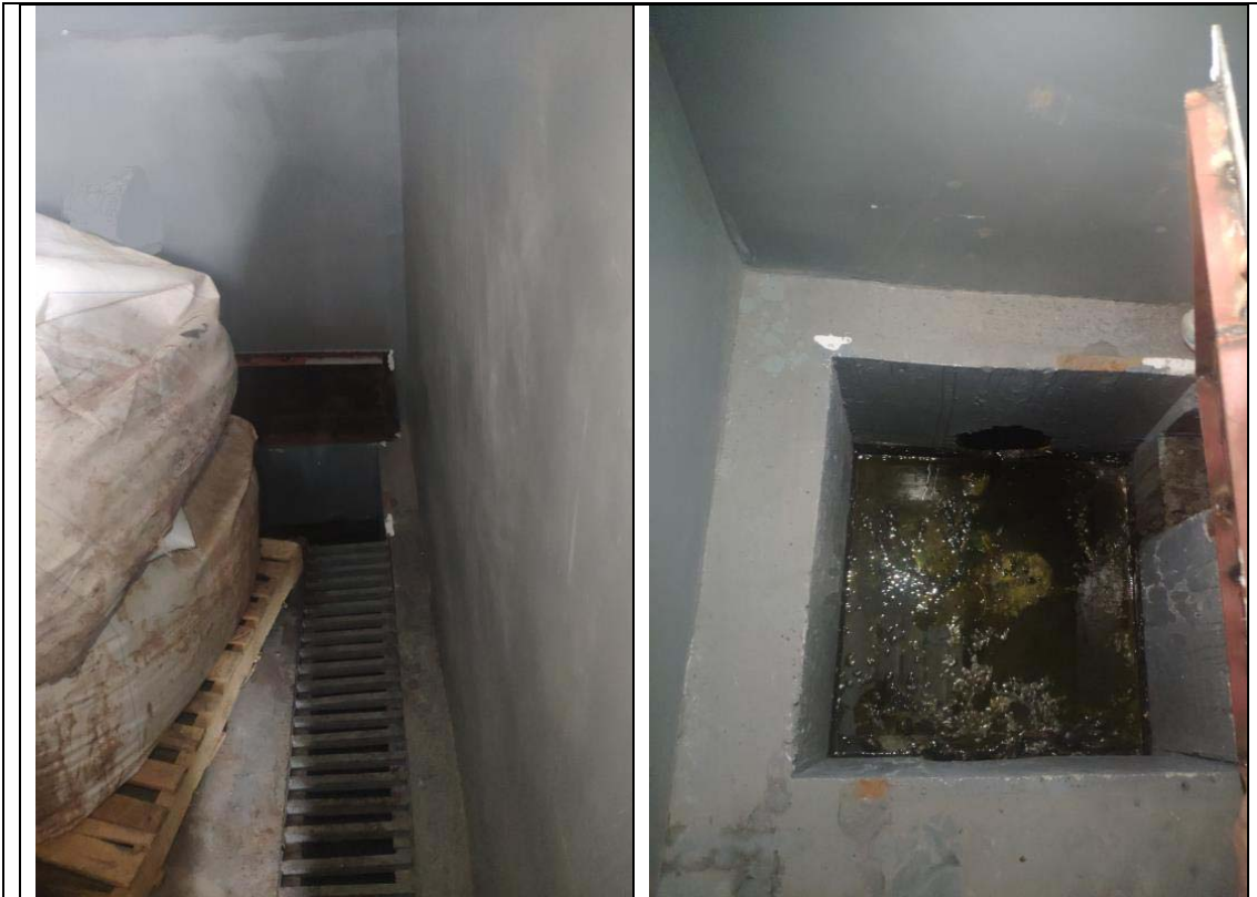
图 11 危废间废液收集设施
