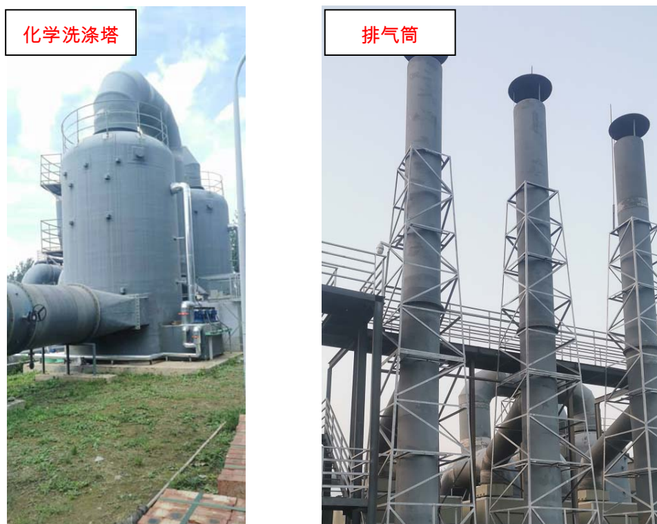
图 4-2 废气治理设施现场照片
