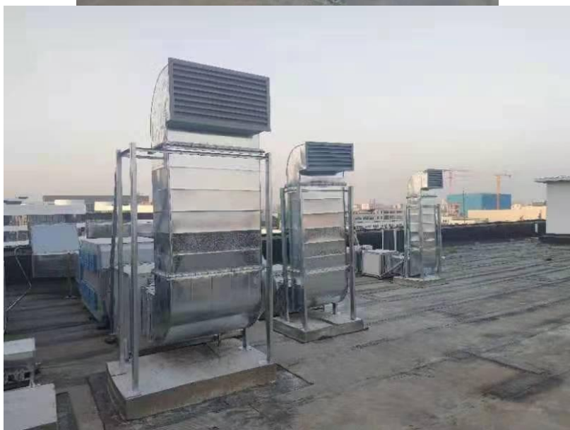
图 4-5 废气治理设施现场照片
