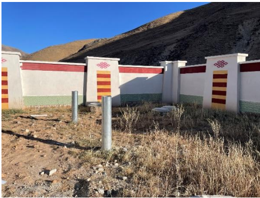
隧道消防救援站污水处理设施
