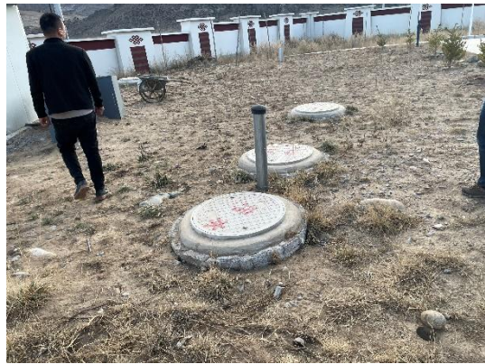
古荣综合执法站污水处理设施
