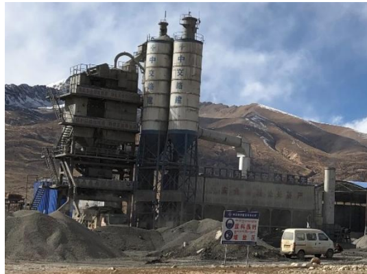
沥青搅拌站及净化器
