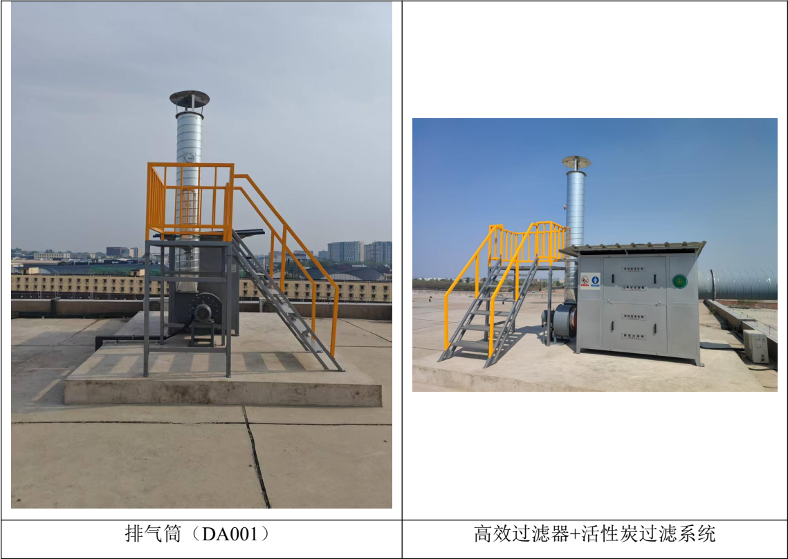
图 4.1-3 废气处理设施
