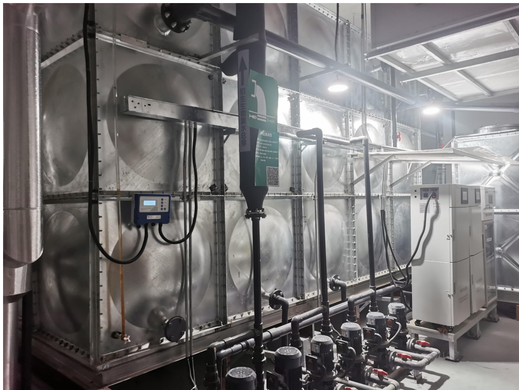
图 4.1-6 一体化污水处理设施及排放口
