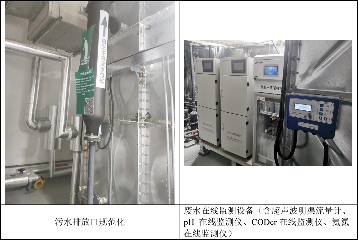
图 4.2-1 废气、废水采样口及规范化照片
