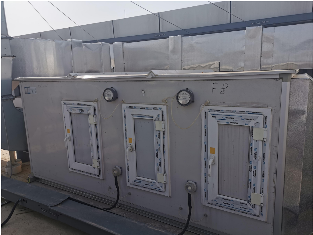
图 4.1-2 活性炭过滤排风箱设施照片
