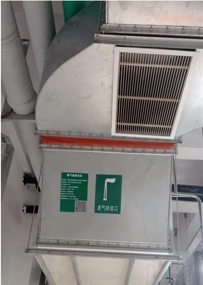
图 4.1-5 废水处理废气排放口
