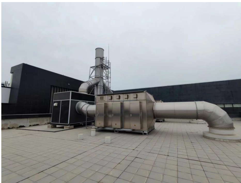
臭气处理系统排气筒
