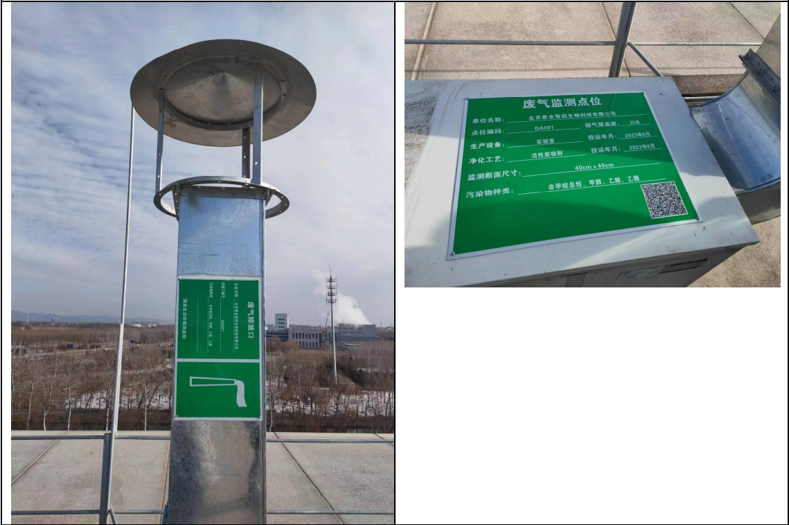
图 4.1-6 废气排气筒规范化情况
