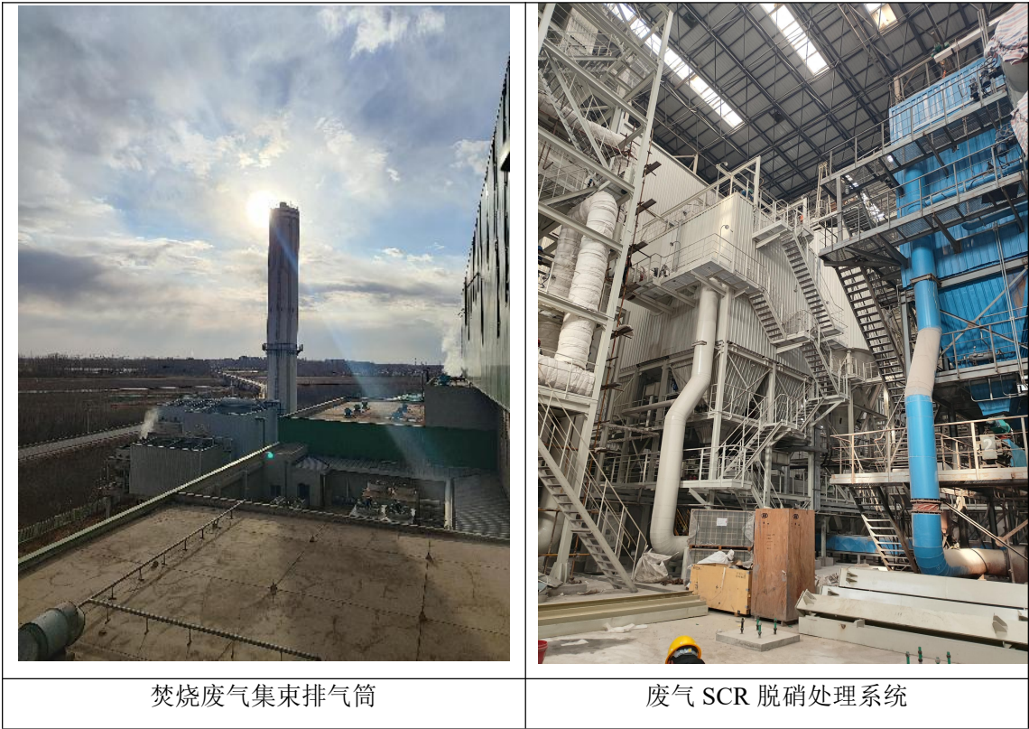
图 4.1-2 废气收集、处理设施
